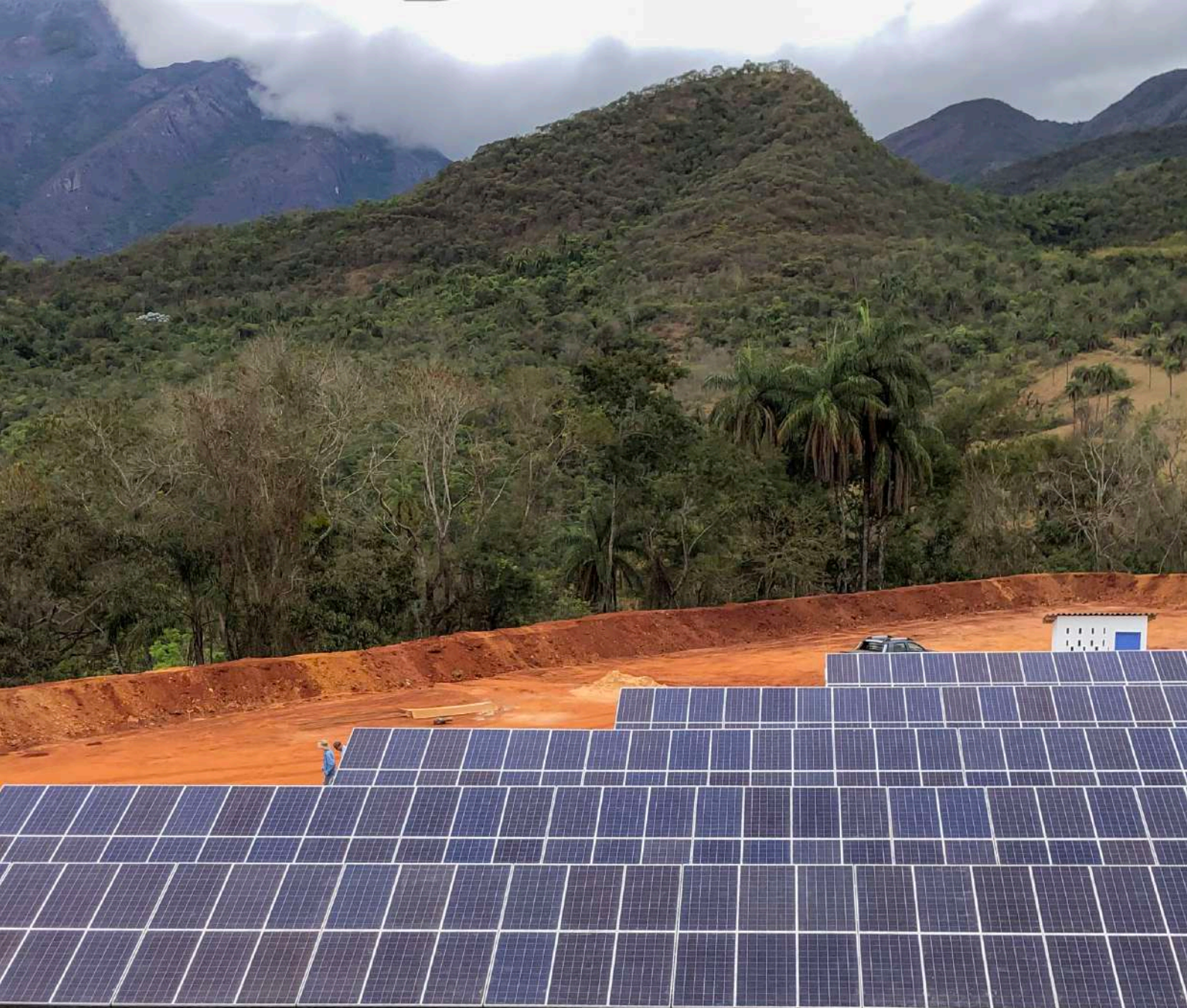
Campus de captação fotovoltaica na Fazenda do Engenho, Caracá
